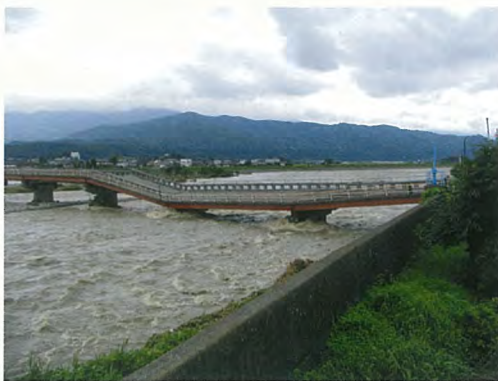
沈下した橋梁 沢渡地区
