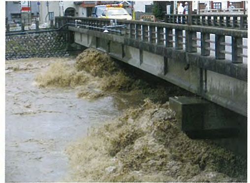
天竜川の出水状況 伊奈地区
